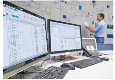
Télé-exploitation : transfert sécurisé et continu des données de process à la centrale de commande
